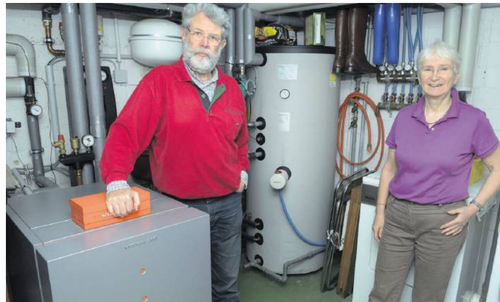
Dörthe Rengeling-Eschweiler und Edmund Eschweiler vor ihrer Heizungsanlage im Keller ihres Einfamilienhauses.
